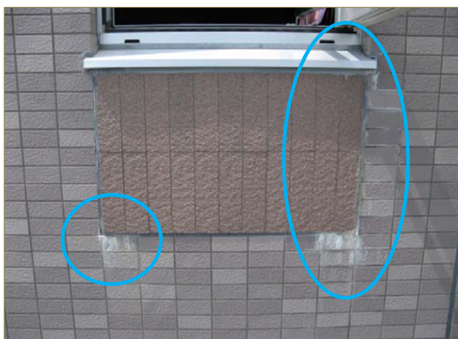
【アルミサッシ周囲の劣化状況】
